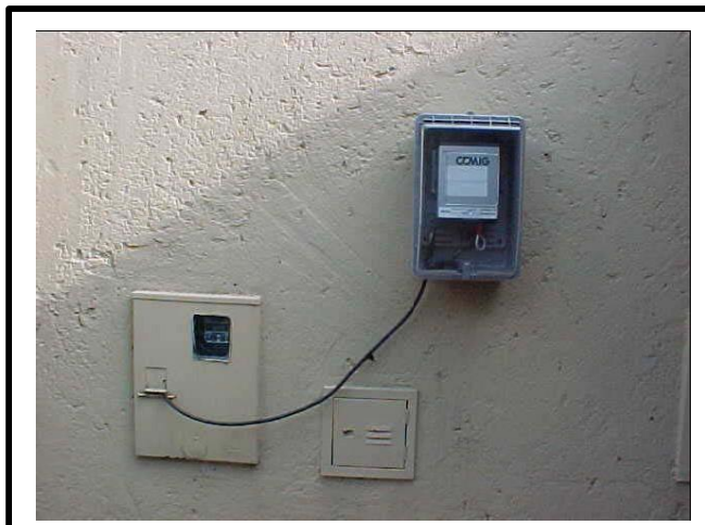
Figura 10: Repetidor colocado próximo ao medidor (Fonte: VARGAS,2004)
