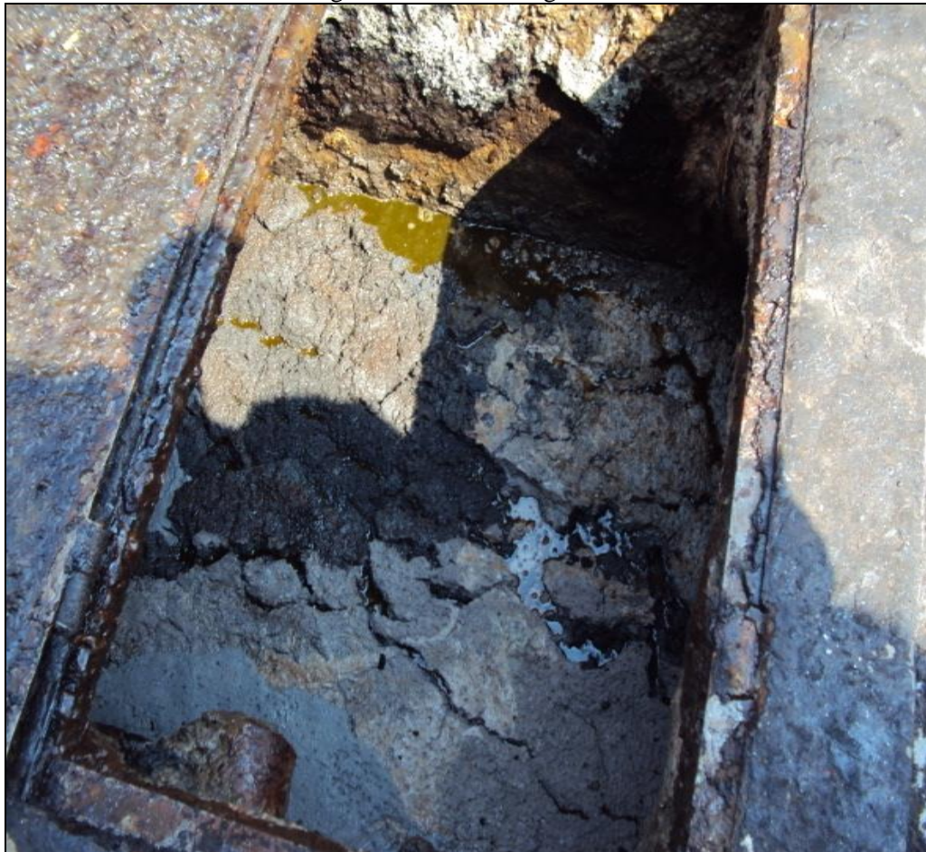
Figura 14 - Caixas de gordura
