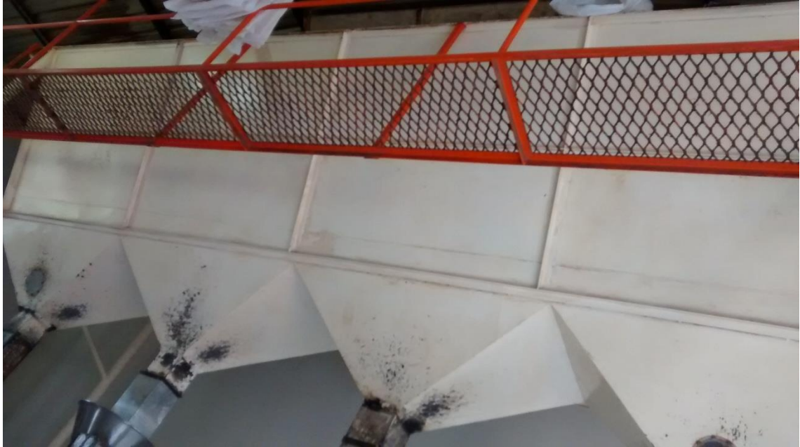
Figura 7 – Silo anexado sobre as empacotadoras
